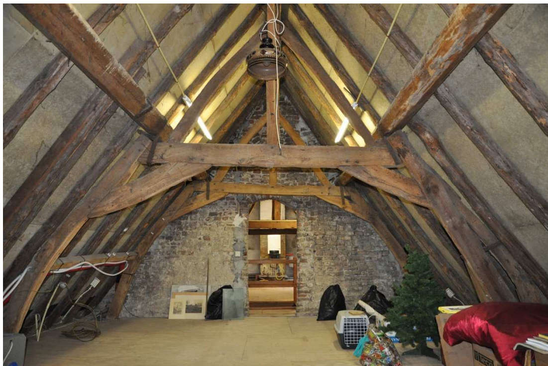
41 De kapconstructie van de woontoren, richting het oosten. De twee oostelijke tussenbalkjucken zijn zichtbaar.
