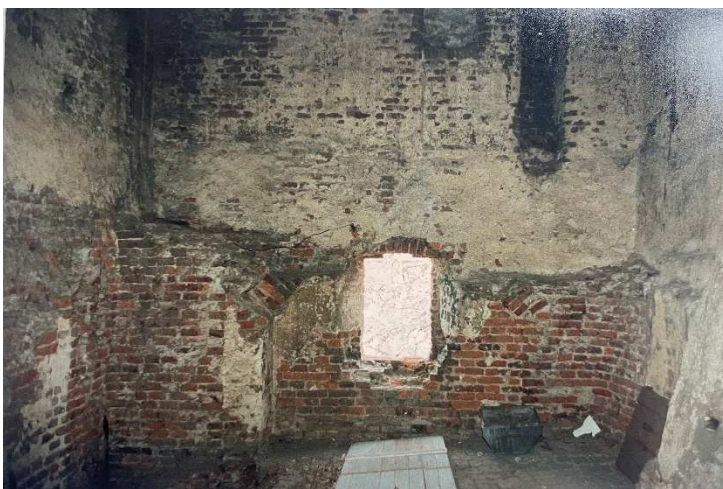
35 De eerste verdieping vóór de restauratie: een balklaag ontbreekt.
