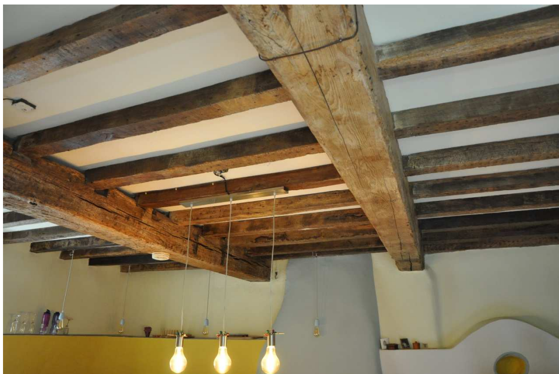
34 De balklaag boven de eerste verdieping werd in 1988 aangebracht en bestaat uit hergebruikte balken uit de gesloopte aanbouw aan de zuidzijde.
